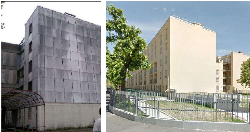
Complesso residenziale ERP di via Feltrinelli 16, pre e post intervento (fonte: progetto EU-GUGLE)
